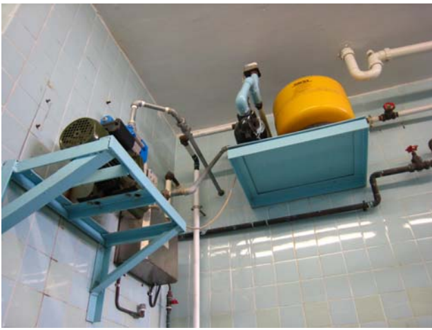
位於六樓男廁之水泵
